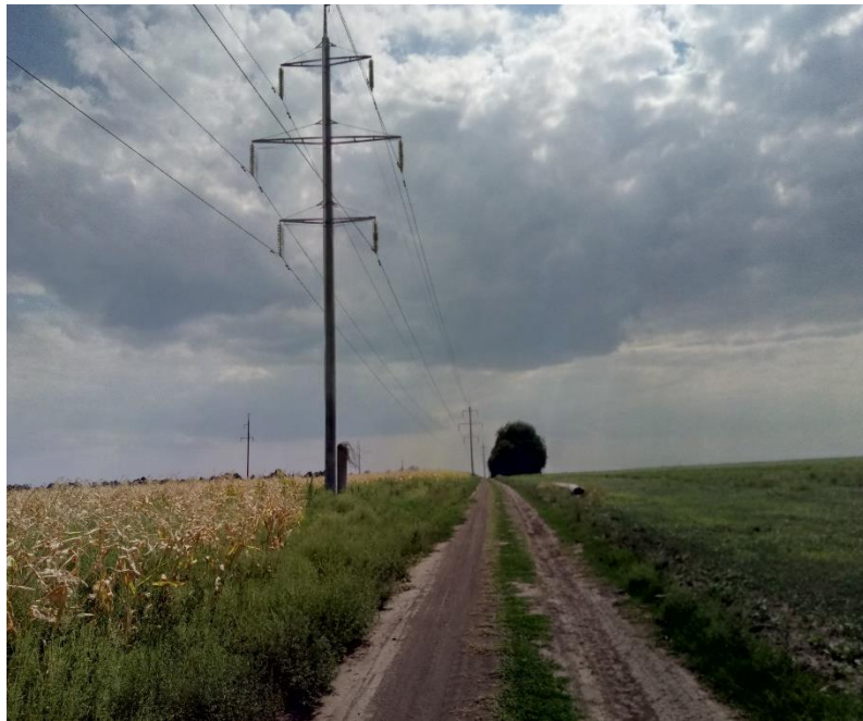
Рис.1.Обстеження оцінка технічного стану залізобетонних центрифужованих стік високовольтних мереж
